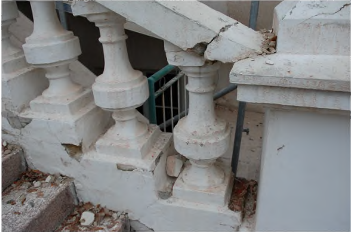
Fot.13 Balustrada – uszkodzenia murowanej poręczy
