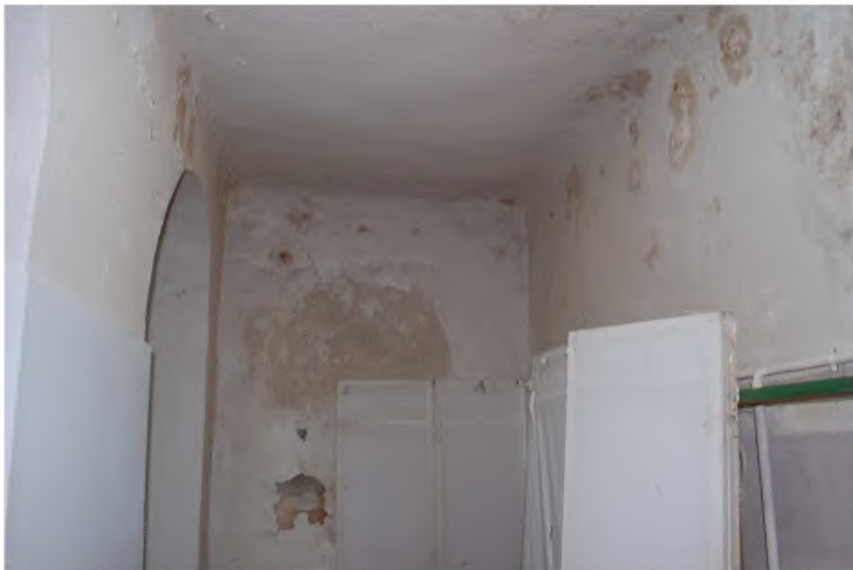
Fot.17 Pomieszczenie piwniczne (magazynek) pod tarasem – korozja tynków
