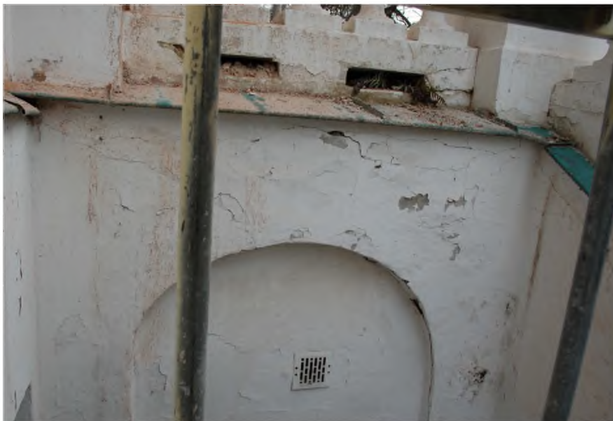
Fot.15 Ściana północna tarasu. Nie drożne odpływy; obróbki blacharskie; wentylacja w ścianie
