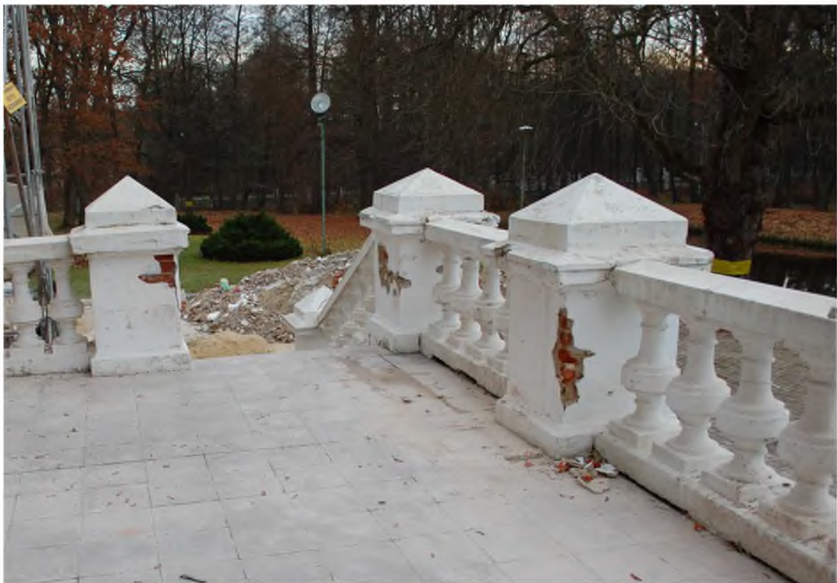
Fot.14 Balustrada – uszkodzenia słupków
