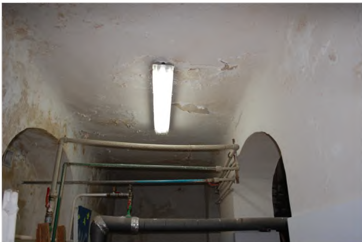
Fot.18 Pomieszczenie piwniczne (magazynek) pod tarasem – korozja tynków
