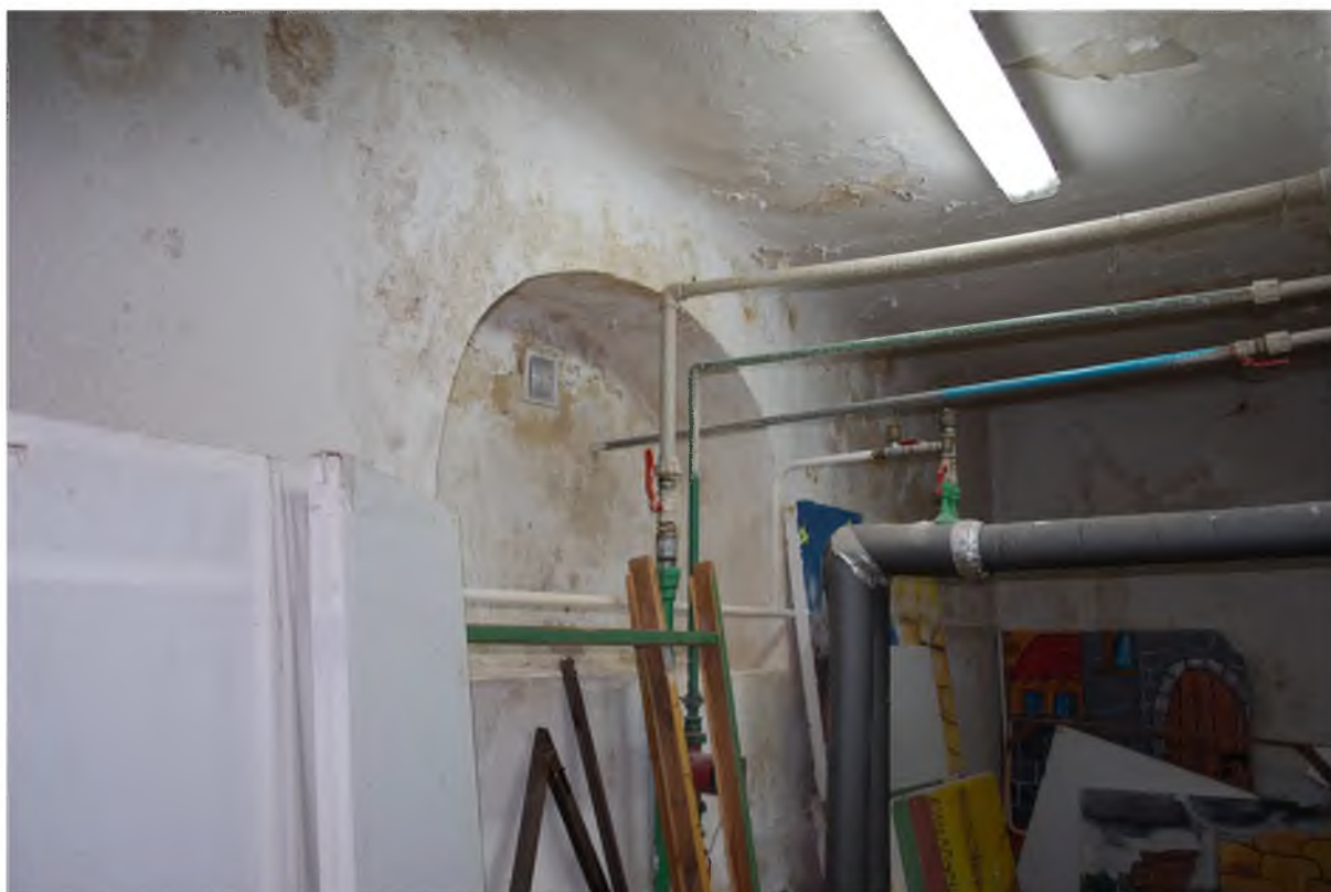
Fot.16 Pomieszczenie piwniczne (magazynek) pod tarasem – korozja tynków
