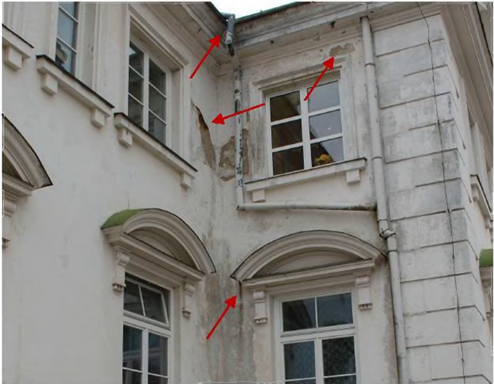
Odparzenia tynku, zacieki, luszcząca się powłoka malarska, nieszczelne orynowanie
