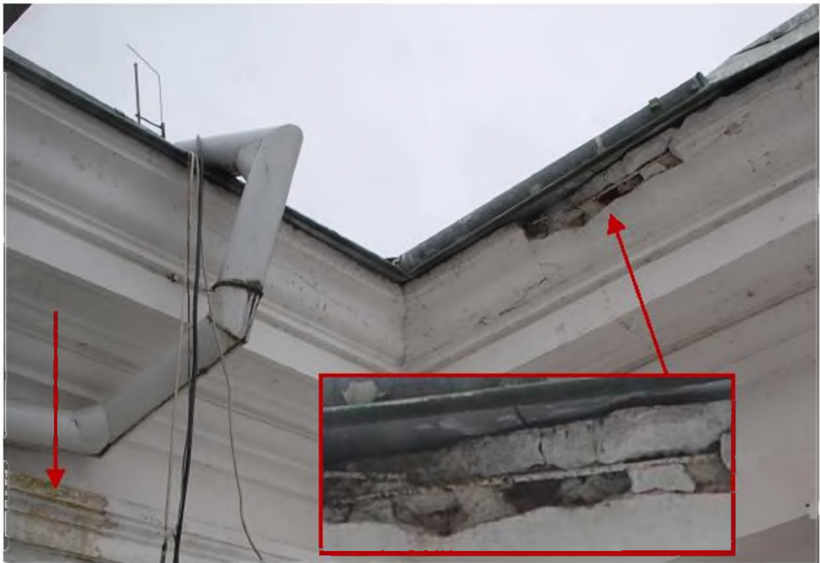
Uszkodzenia gzymsu, zacieki, odsłonięte zbrojenie
