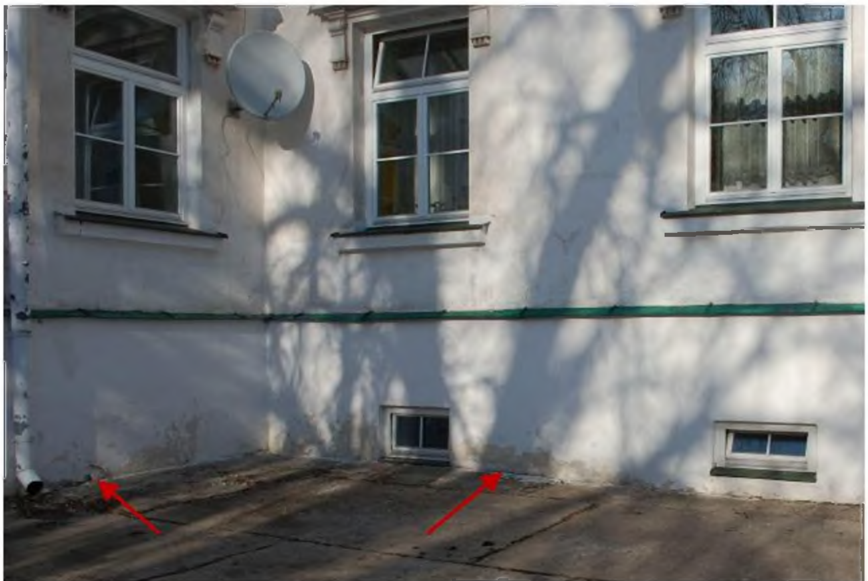
Spękania i odparzenia tynku, luszcząca się powłoka malarska
