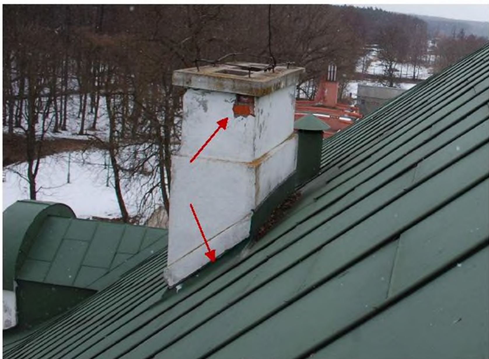
Odspojenie tynków na kominie, nieszczelne obróbki blacharskie
