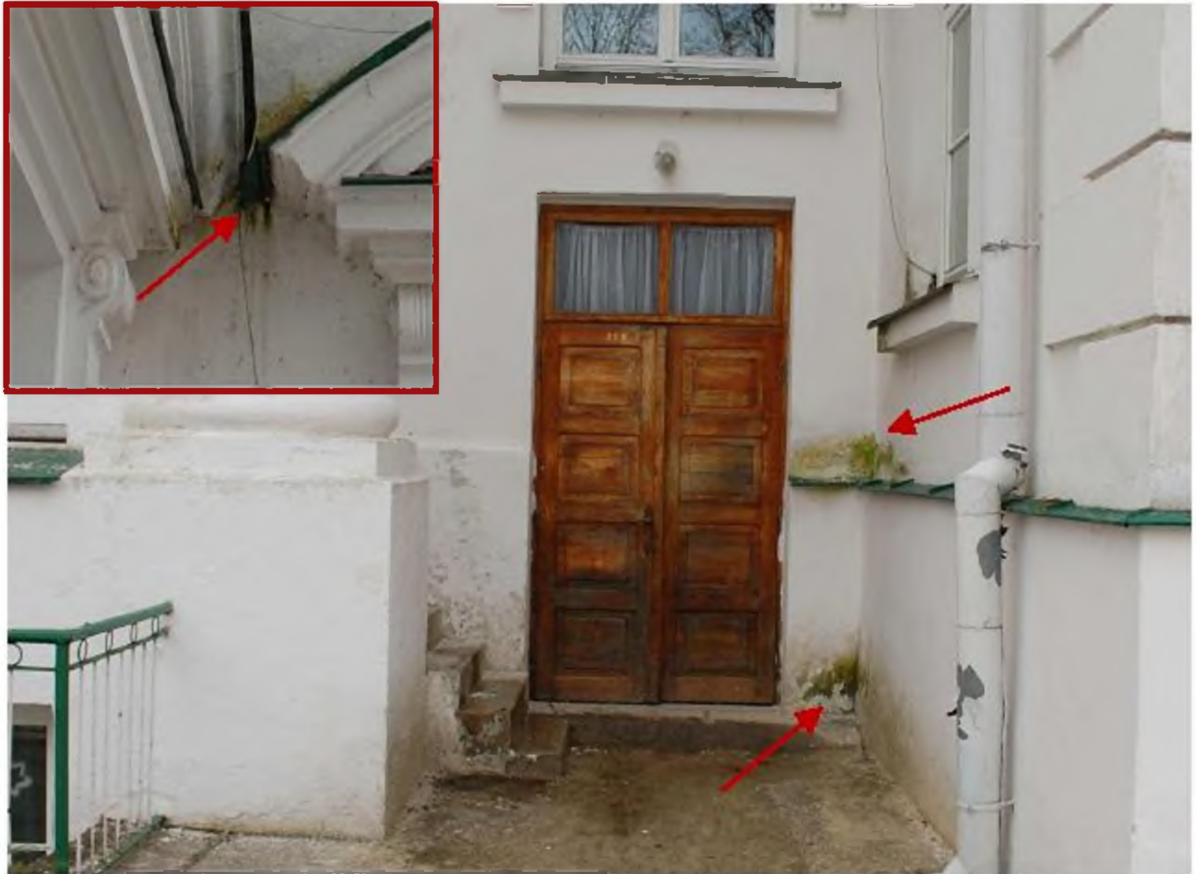
Korozja biologiczna cokołu i okolic obróbek blacharskich gzymsów okiennych (zdjęcie po lewej)
