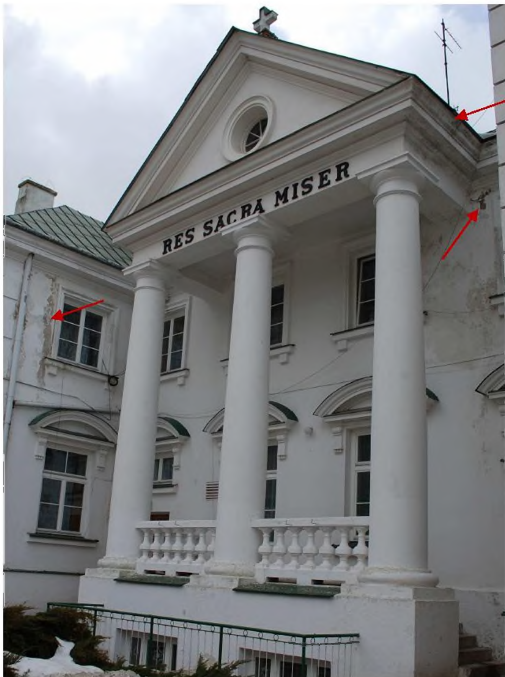
Łuszcząca się powłoka malarska, nieszczelności obróbek blacharskich
