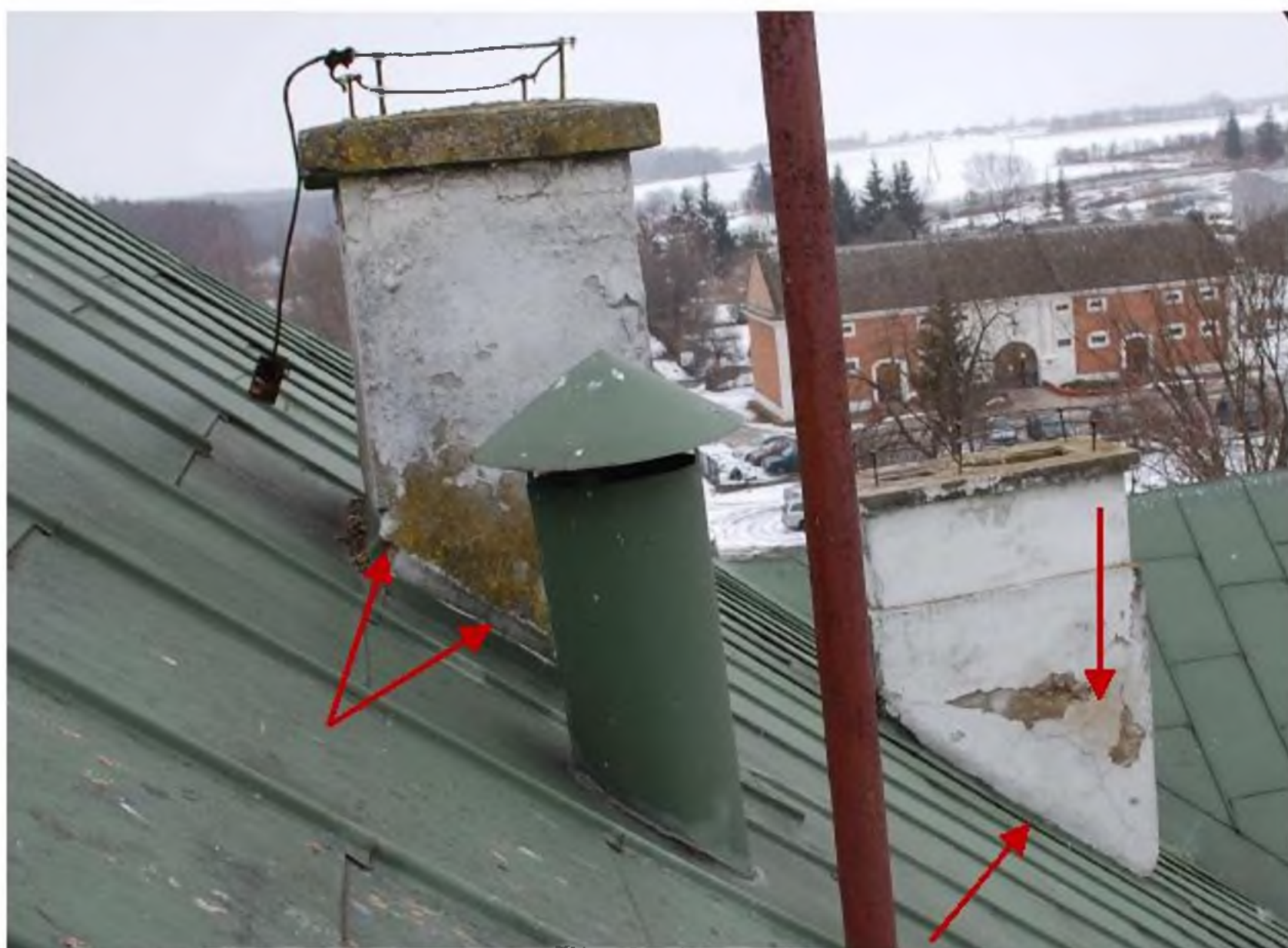
Spękane tynki na kominach, nieszczelne obróbki blacharskie
